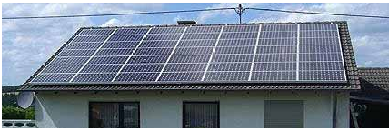
Allemagne 49 panneaux en superposition pour 11 kWC Source forum-photovoltaïque
